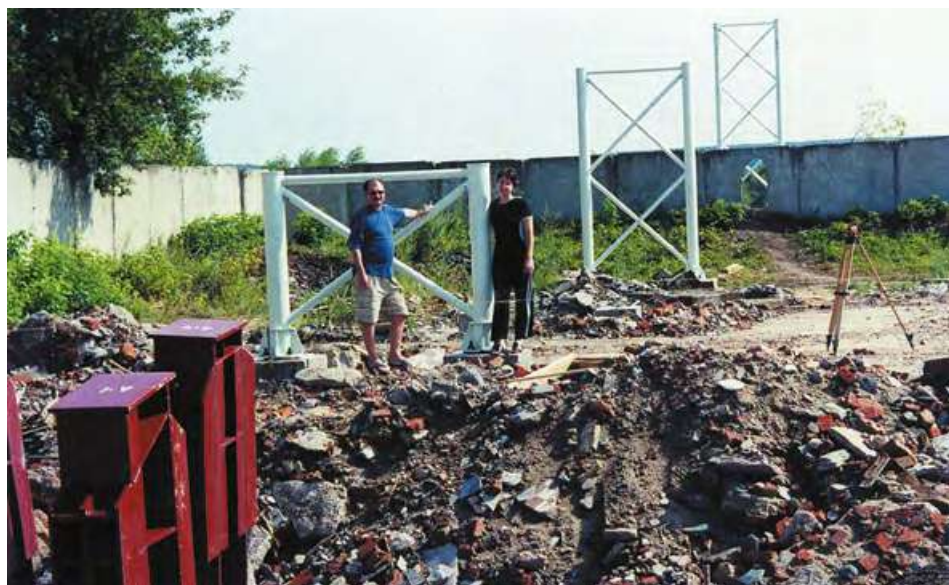
Анатолий Юницкий и Надежда Косарева на строящемся стенде «Путевая структура» испытательного полигона СТЮ, г. Озёры Московской области, июнь 2001 г.
