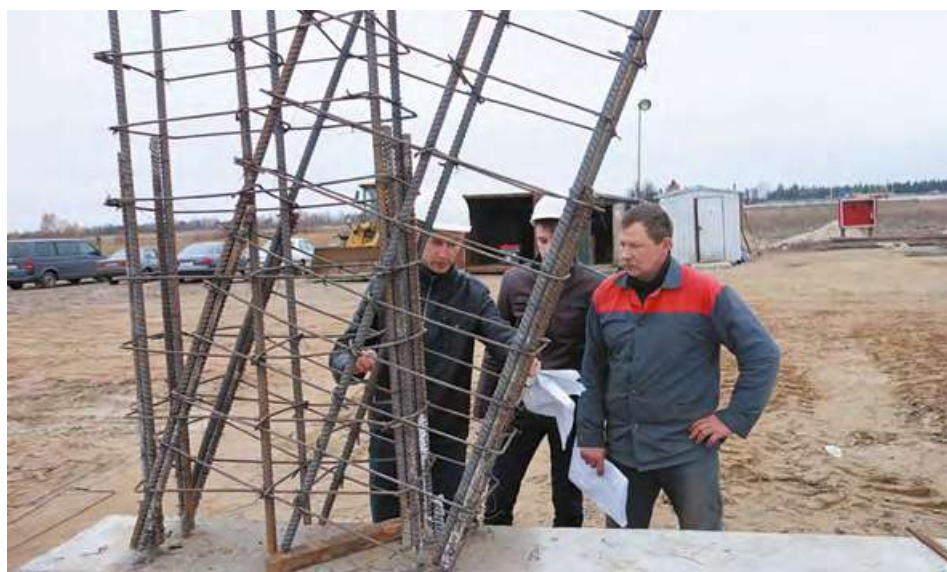
Строительство пилонов первой анкерной опоры высокоскоростного SkyWay, ЭкоТехноПарк, г. Марьина Горка, ноябрь 2015 г.
